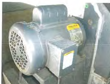
Figura 16. Motor de cámara de fumigación
