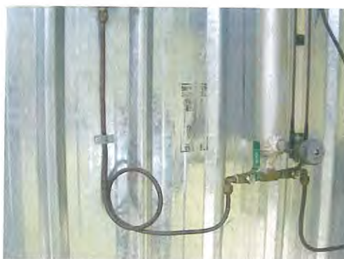
Figura 18. Tubería de cobre.
